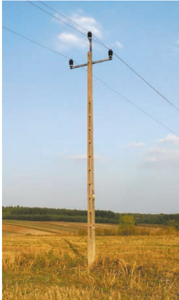
Jeden z wielu słupów ustawionych na gruncie prywatnym bez zgody właściciela
