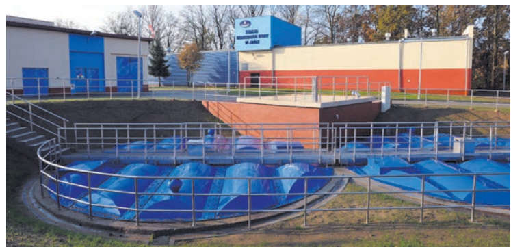
Stacja Uzdatniania Wody w Jasle
