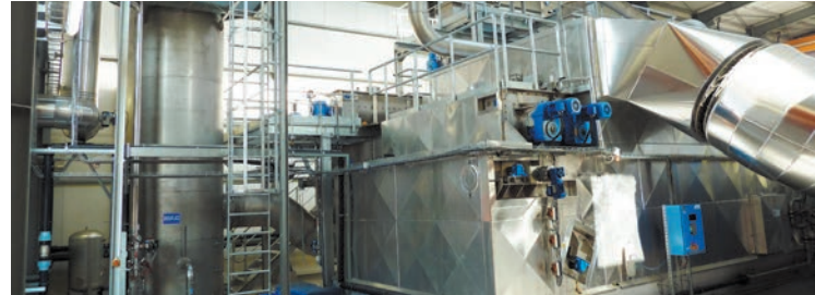
Węzeł Termicznej Utylizacji Osadów Ściekowych w Oczyszczalni Ścieków w Koszalinie
